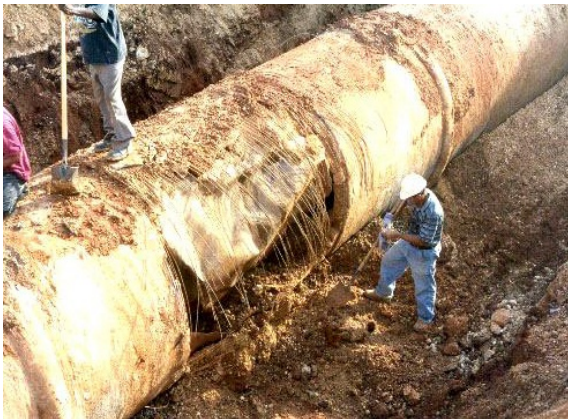
Rottura in seguito ad un transitorio di pressione (superaqueduct of Puerto Rico)
