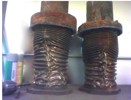
Giunti di espansione deformati da un colpo d'ariete
